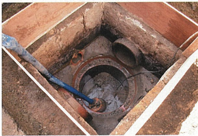
㉑配水路間枡
