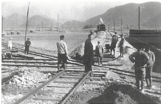
2 国鉄建設中は、赤穂鉄道との交差部分に人力でレール枠を取り付けた。
